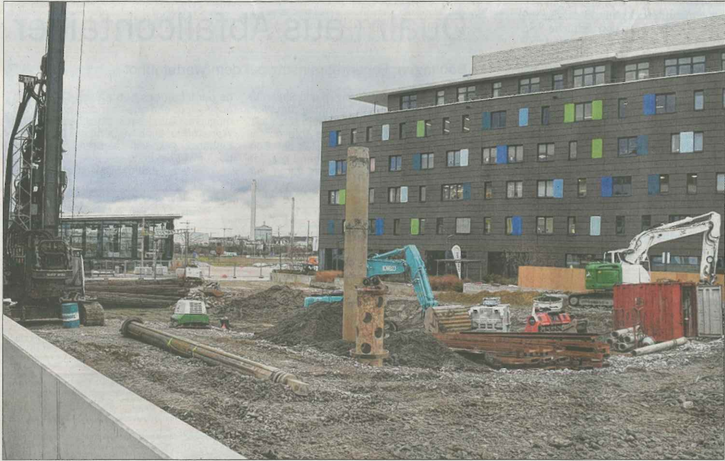
An der Konrad-Zuse-Straße wird die Baugrube für die Kindertagesstätte und die Mikroapartments ausgehoben.
